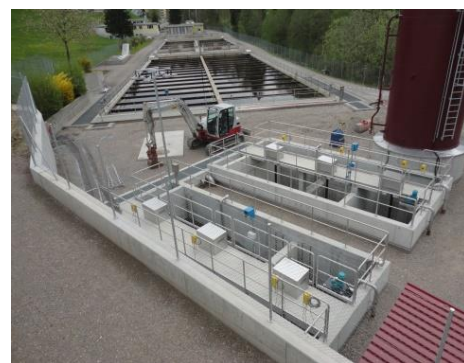
Reaktionsbecken der PAK-Stufe mit PAK-Silo
