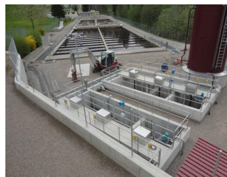
Reaktionsbecken der PAK-Stufe mit PAK-Silo
