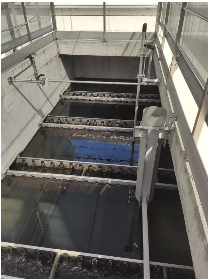
Abbildung 2: Einer von drei GAK im Schwebebett Reaktoren, Draufsicht mit Ablaufrinnen.
