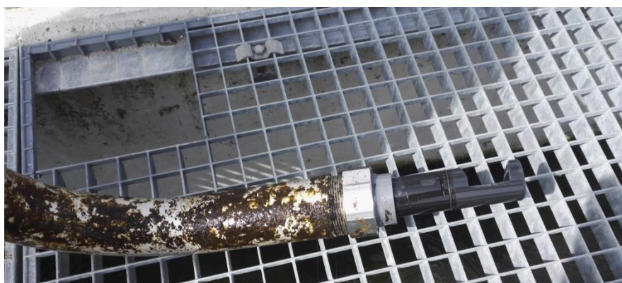
Figura 10: Sonda SAC 254,out con fenditura di misura da 35 mm all'IDA Reinach (LED come sorgente luminosa), Oberwytental, montata ad immersione nel sottostante canale a monte della filtrazione a sabbia, foto piattaforma
