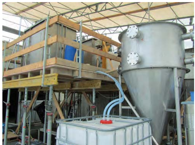
Abb. 1: Versuchsanordnung zur Pilotierung der Dosierung von PAK in die biologische Reinigung (Foto: KomS)
