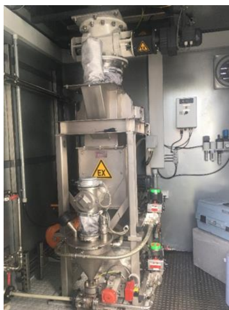
Figure 7 : Installation mobile pour le dosage de CAP
