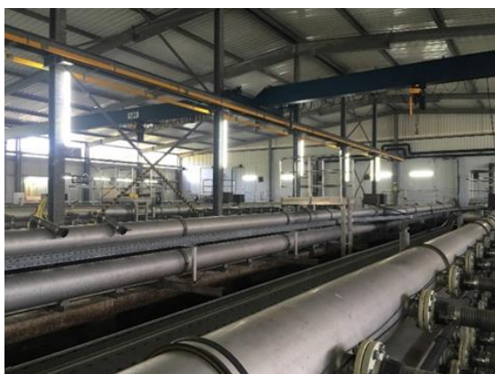
Figure 6 : Biologie membranaire de la station d'épuration de Kaarst-Nordkanal
