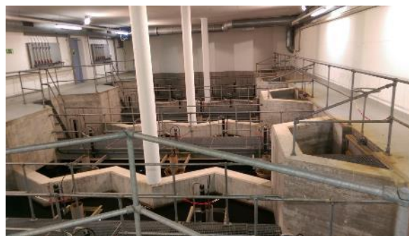
Fig. 5 : filtration existante à la STEP de Moos dans le système DynaSand
