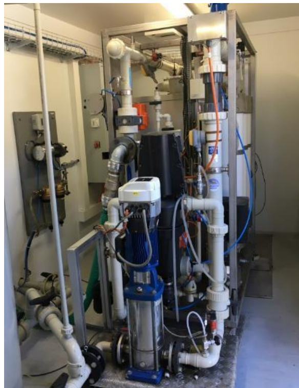
Fig. 3 : Le pilote d'ultrafiltration.
