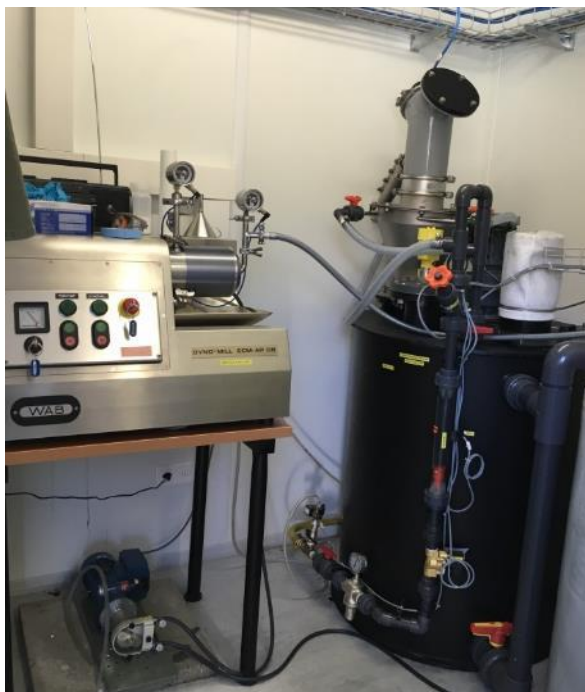
Fig. 2 : Broyeur et cuve contenant la solution mère de CAP
