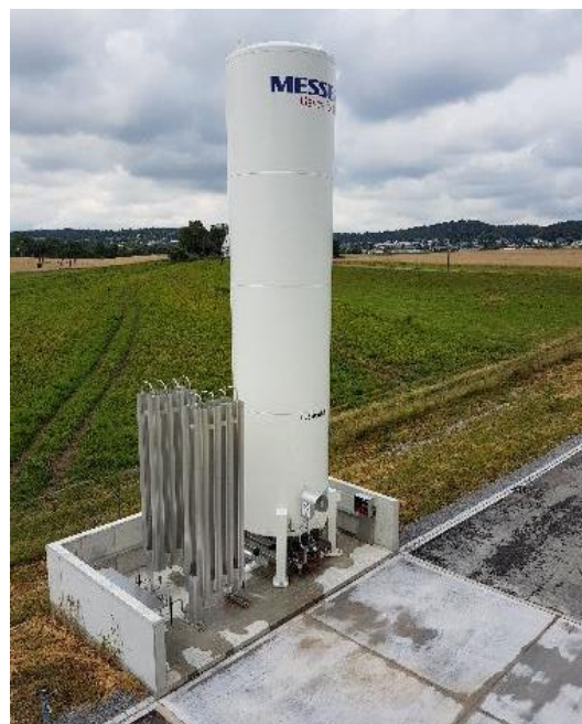
Fig. 8: Réservoir de stockage de l'oxygène liquide à la STEP d'Eich, Bassersdorf
