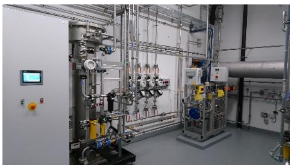
Fig. 7: Vue du local produisant l'ozone de la STEP d'Eich, Bassersdorf
