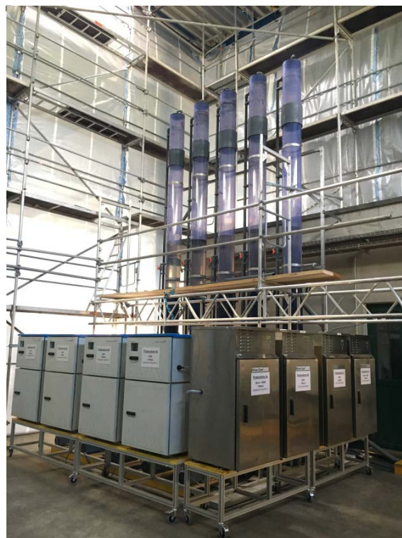
Illustration 4 - Installation pilote avec 5 colonnes de CAG
