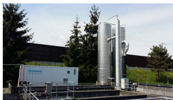
Illustration 3 - Installation pilote avec ozonation
