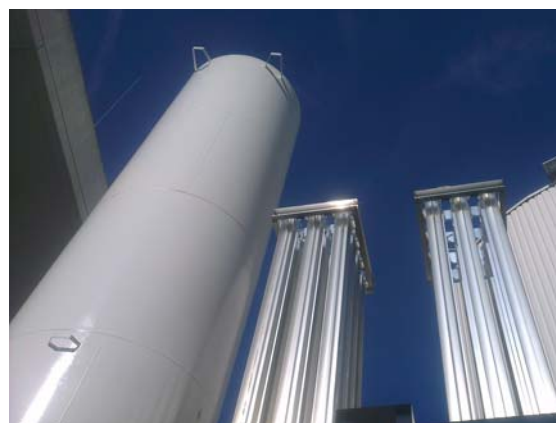
Illustration 1: Réservoir utilisé pour le stockage de l'oxygène liquide (à gauche) et les deux évaporateurs (à droite) de la STEP de Neugut (photo: HOLINGER AG).
