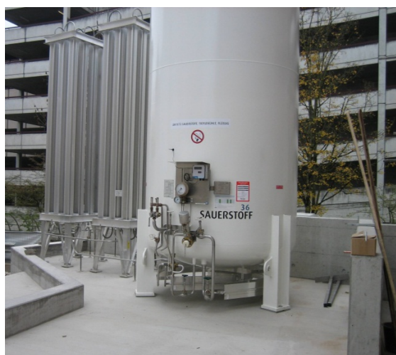
Illustration 2: réservoir et évaporateur d'oxygène à la STEP Neugut à Dübendorf (photo: Holinger AG)
