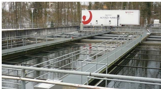
Installation pilote Actiflo-Carb (image: Rapport final)
