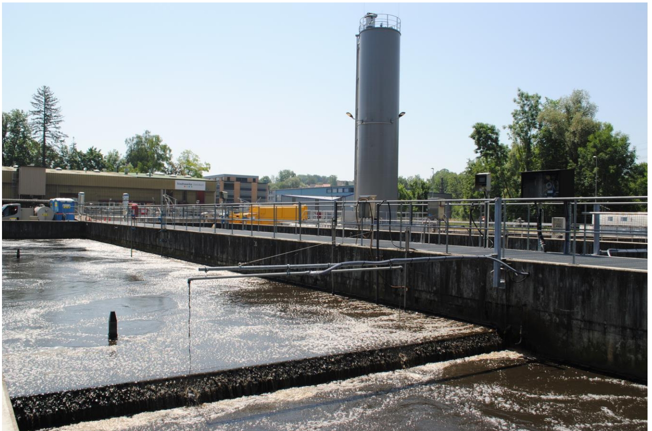
Abbildung 2: PAK-Dosierstelle in die Belebtschlamm-Biologie
