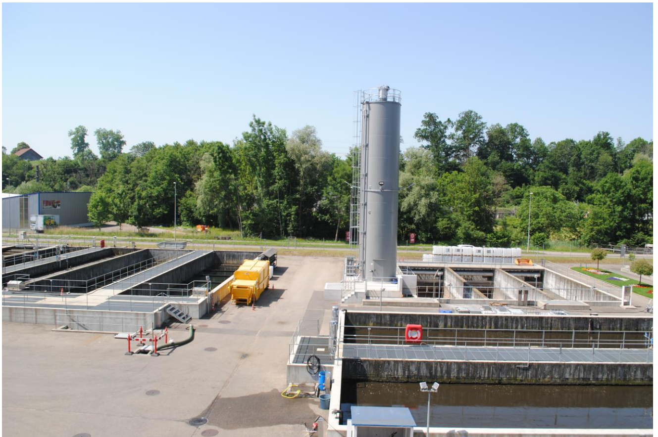
Abbildung 3: PAK-Silo mit integrierter Dosierstation
