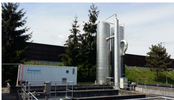
Abbildung 3 - Pilotanlage mit Ozonung
