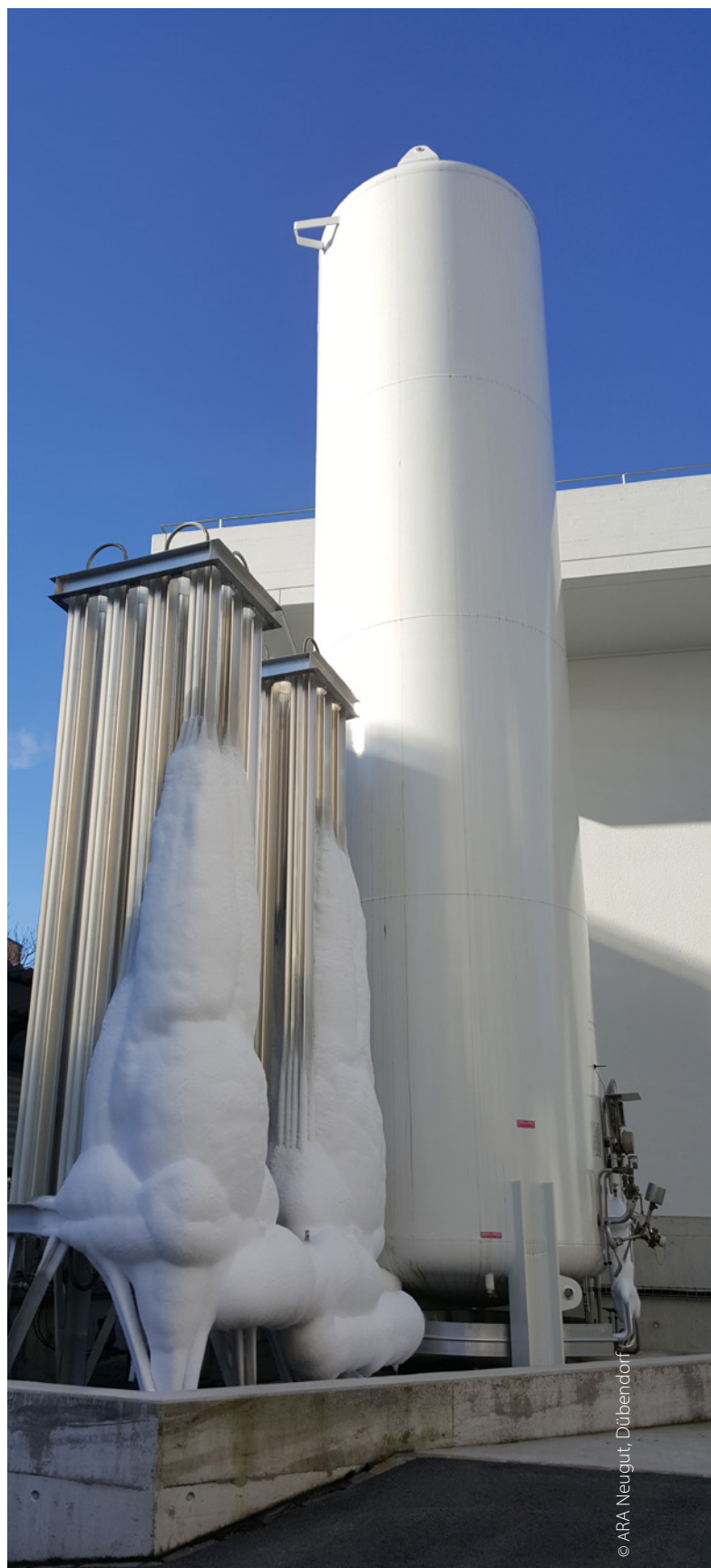
Ozonung der Abwasserreinigungsanlage (ARA) Neugut in Dübendorf: Tank mit flüssigem Sauerstoff zur Ozonherstellung und Verdampfer im Vordergrund
