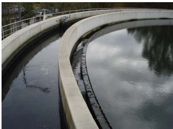
Abbildung 3: Beispiel eines runden Kombibeckens auf dem Klärwerk Böblingen-Sindelfingen (D): Kontaktzone im äusseren Ring, Sedimentationszone im inneren Bereich (Foto: Plattform).
