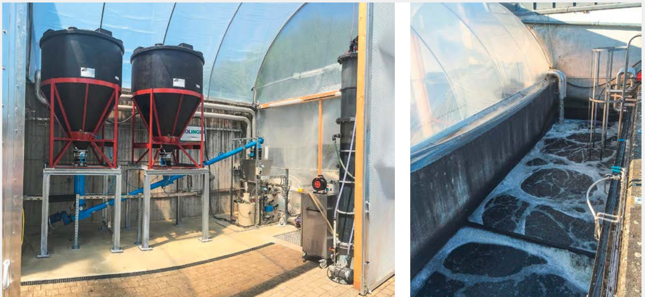
Fig. 3 PAK-Lager- und Dosiereinrichtung (links) und Zone 1 des Flockungsreaktors (rechts) auf der ARA Ergolz 1
