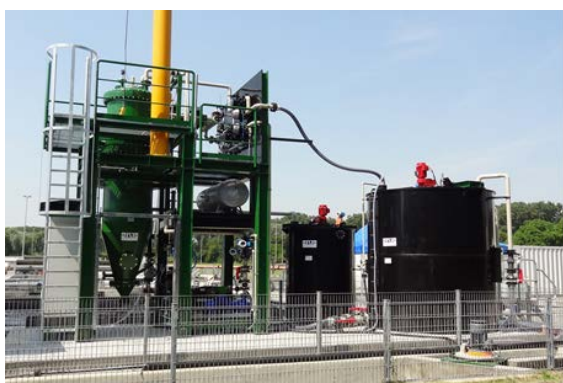
Abbildung 3. Testanlage in Mannheim mit einer Filterfläche von 13 m 2 für 30 m 3 Abwasser pro Stunde.
