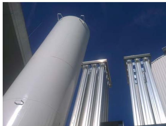
Abbildung 1: Tank für die Lagerung des flüssigen Sauerstoffs (links) sowie die beiden Verdampfer (rechts) auf der ARA Neugut (Photo: HOLINGER AG).
