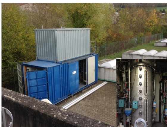
Abbildung 1: Ansicht auf den 2-strassigen Raumfilter im Pilotmassstab (Bild: FHNW)
