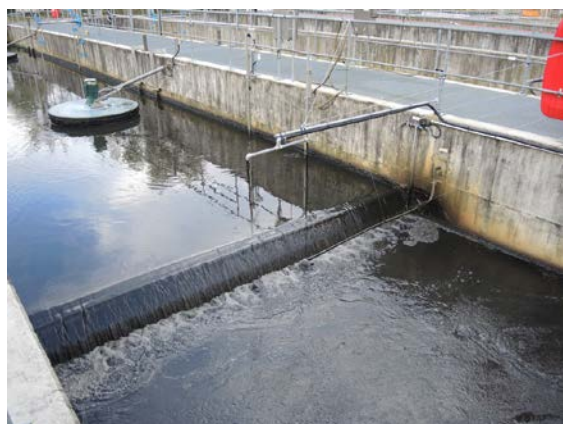
PAK-Dosierstelle (Bild: AWEL)
