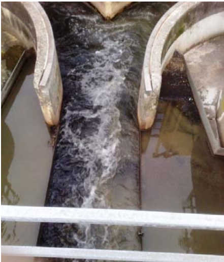
Abbildung 7 Einmischung des schwarzgefärbten Rückspülwassers in den Zulauf zum belüfteten Sand-/Fettfang
