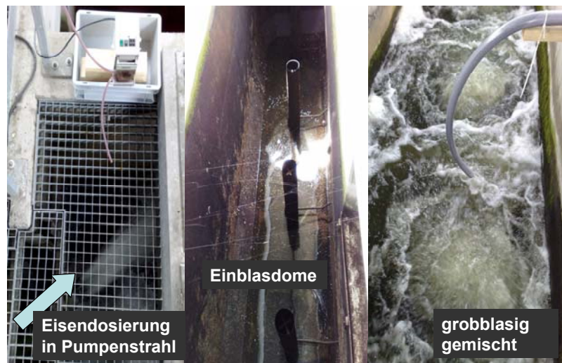
Abbildung 5A-C Dosierung von Eisen (III)-Chlorid (A) und PAK-Suspension (B+C) in den Flockungsreaktor
